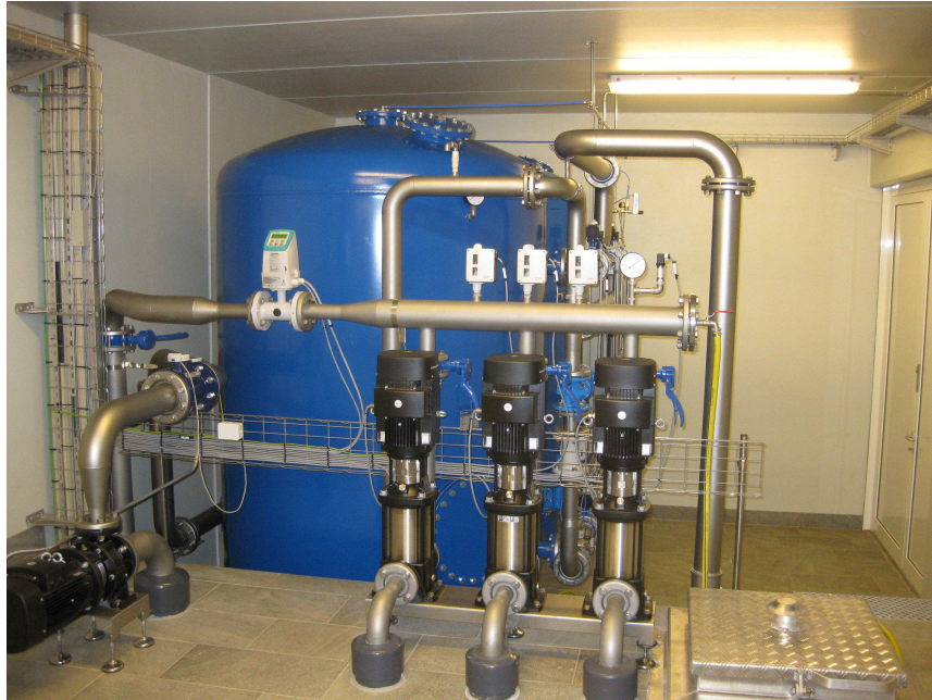
Figur 5: Viser for- og efterfilter samt 3 af rentvandspumperne og lemmen ned til rentvandstanken
