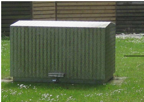
Figur 2: Viser råvandsstationen med DGU nr. 54.757
