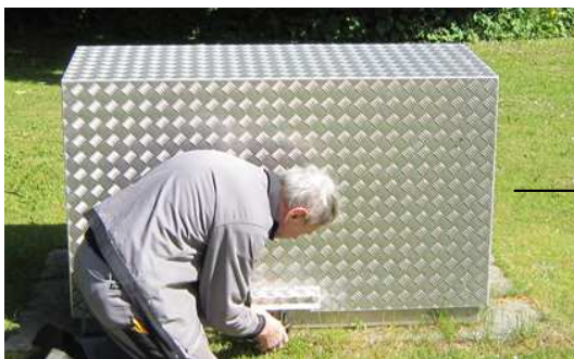
Figur 3: Viser råvandsstationen med DGU nr. 54.112
