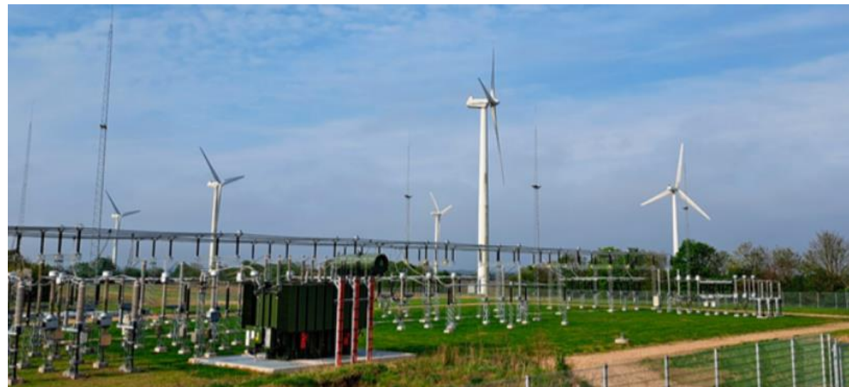
del af transformerstation Idomlund
