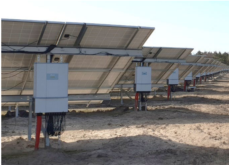
Strenginvertere sidder under solpanelerne.
