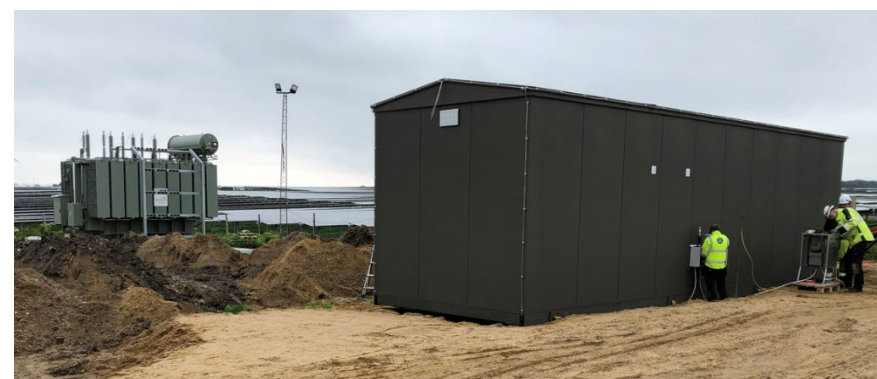
Eksempel på koblingsstation.
